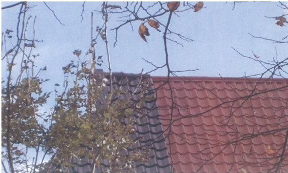
Slechte detaillering aansluiting dakpannen/dakpanprofielplaat
